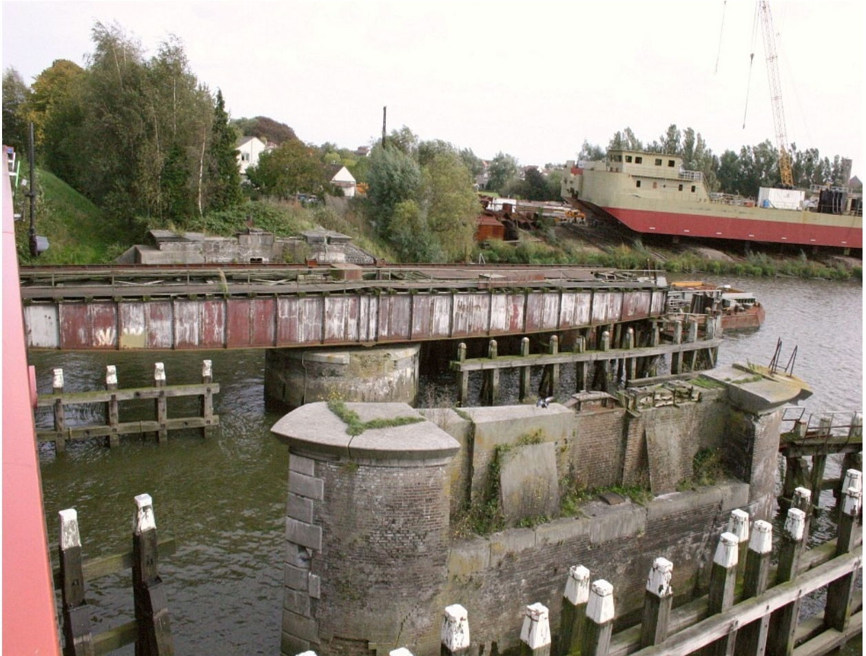
De Donge-spoorbrug in oktober 2004, gezien naar het oostzuidoosten. Op de voorgrond pijler II, in het midden de draibrug op z'n draaipenent, op de achtergrond het oostelijke landhoofd (foto ir. A. den Ouden, oktober 2004)
